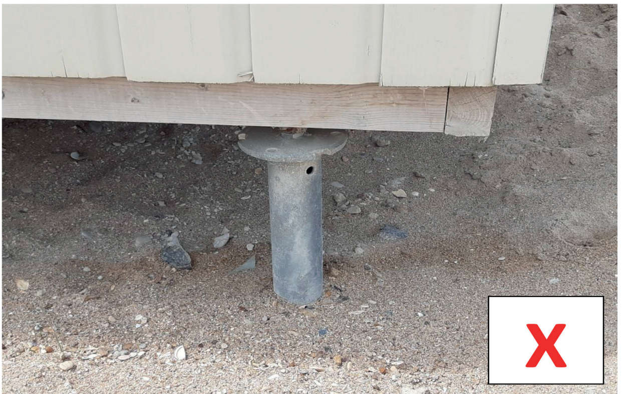
Fondation non conforme
