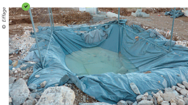
Exemples de fosses étanches de récupération des résidus de nettoyage des goulottes des toupies béton.
